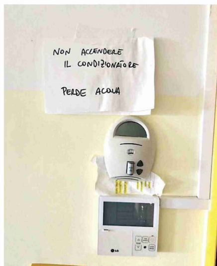
Il messaggio affisso a uno dei termostati del condizionatore
